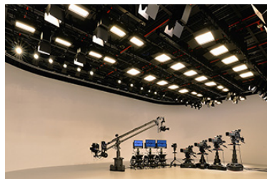
テレビ東京のスタジオに付けられたLED照明
