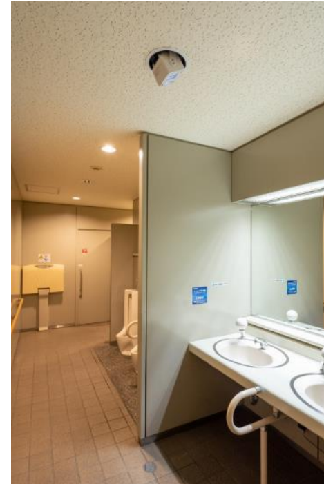
トイレ：洗面台をUVeeで斜めに照射
