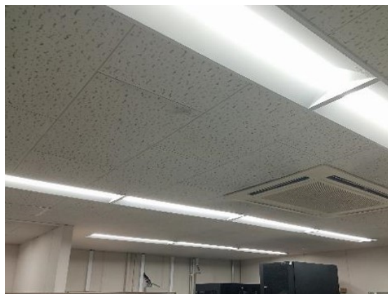
鹿沼工場事務所のLED照明
