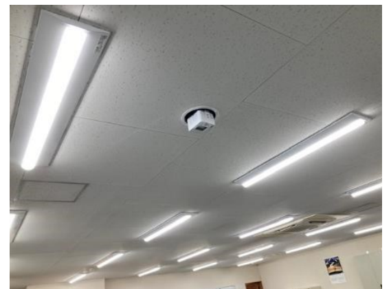
東芝電材マーケティング事務所のLED照明
