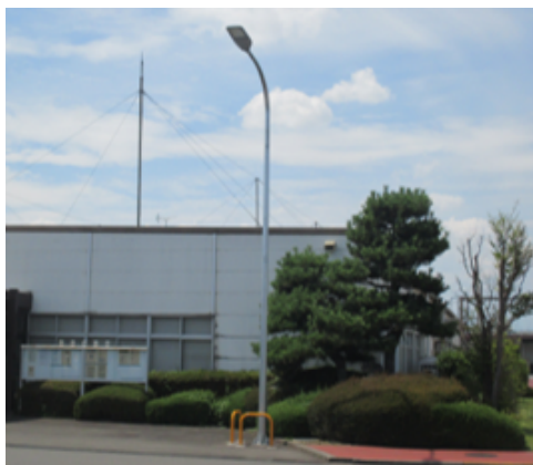
鹿沼工場の外灯照明
