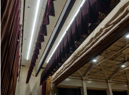
多賀小学校 体育館（舞台） 調光タイプのTENQOOシリーズ⑦を採用しダイヤル式コントロールクスも設置
