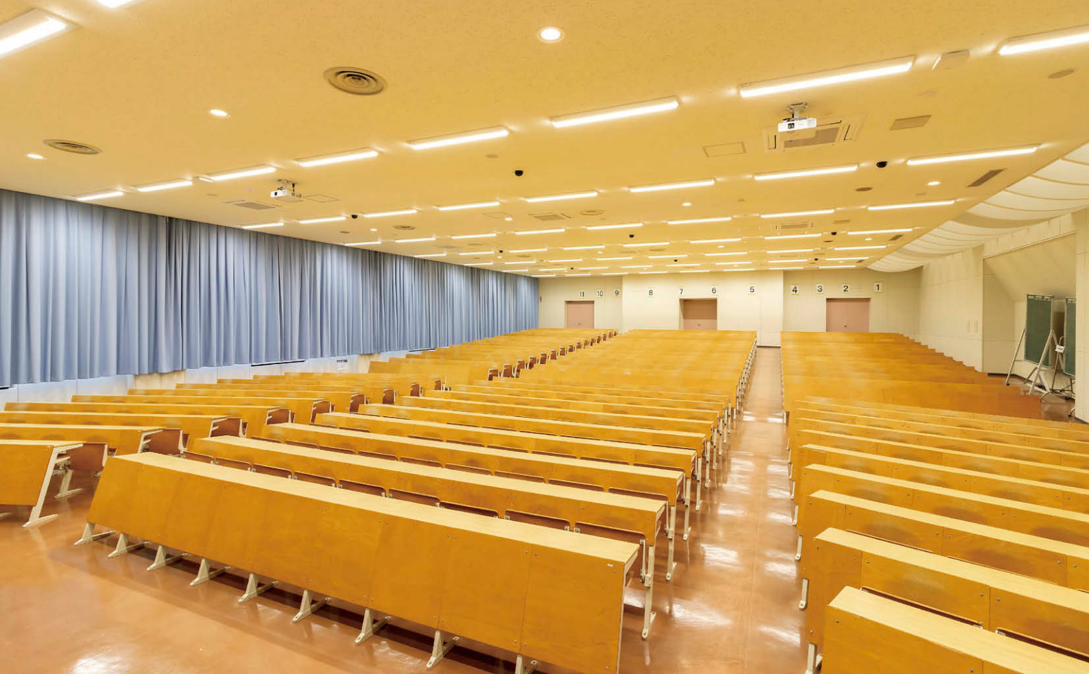
大教室 天井の高い階段状の大教室もLEDベースライト TENQOOシリーズ①とLEDユニット交換形ダウンライト⑤で全体をムラなく照射
