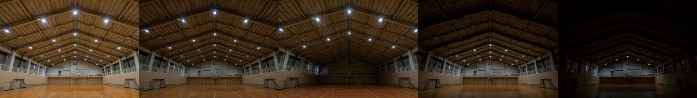
岩屋体育センター アリーナ 明るさの異なるLED高天井器具①②③④を配置し均斉度（最小/平均）0.6以上を確保 写真は100%全点灯（大写真）、50%調光、25%調光、後方50%点灯、前方50%点灯、出入口部分のみ50%点灯（小写真左から）
