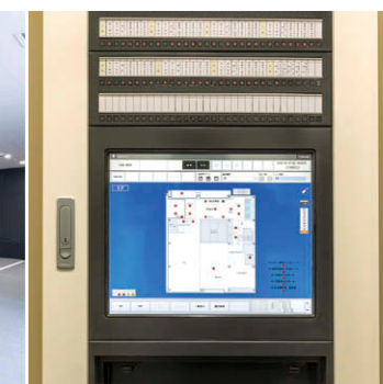
照明制御システム MESLにより施設全体の照明を一括管理
