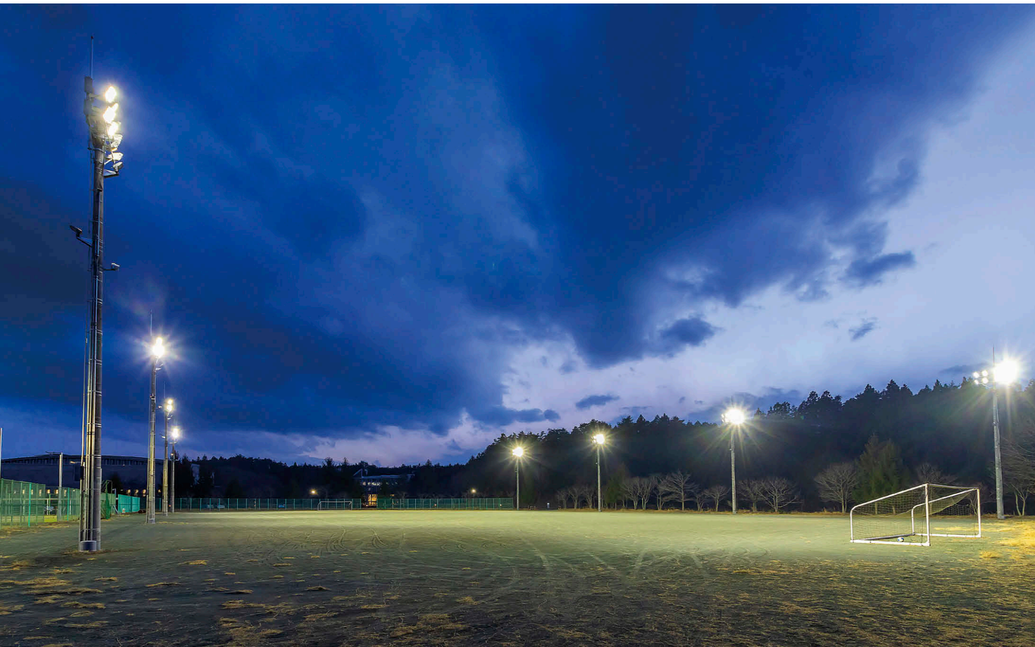
グラウンド 1kWメタルハライドランプ器具相当のLED投光器①64台を既設の高さ15mの照明柱8本に8台ずつ設置。(トラック内平均照度470ルクス)
