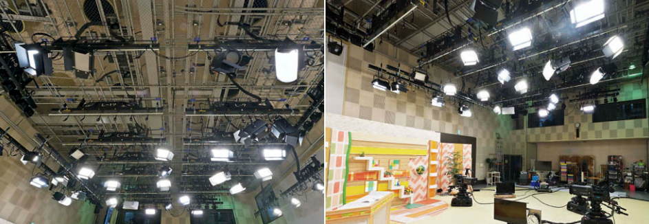
バトンへの器具設置状況 33掛のバトンに配置されたLED照明器具①②③
