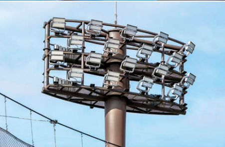
既設照明塔に設置されたLED投光器
