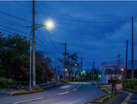
道路灯 道路照明に必要な明るさに応じてLED道路灯⑦等へ更新
