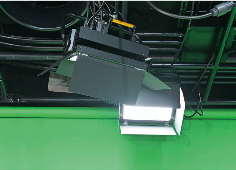
クロマキー上部の照明配置 LEDフラッドライト①
