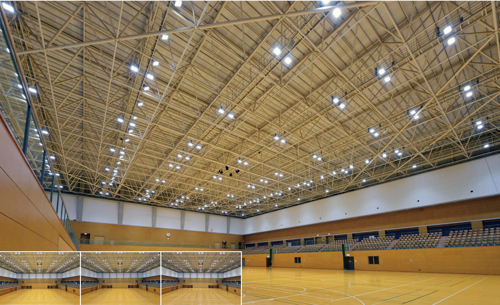
メインアリーナの照明 高さ約16.5mの天井にLED投光器①②を計142台配置して視認性の高い競技環境を創出 点灯パターンは30パターンを登録（左下写真左から：テレビ撮影用の100%全点灯/50%点灯/間引き点灯）
